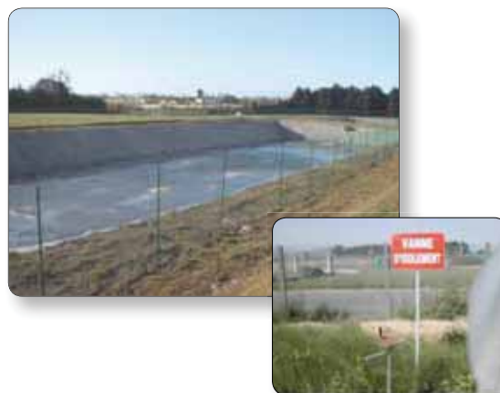
Photos 18 : Bassin de rétention des eaux d'incendie et vanne d'isolement
