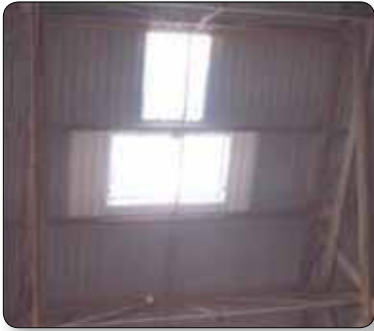
Photo 8 : Exutoires automatiques ou à déclenchement manuel en toiture (CAP Seine)
